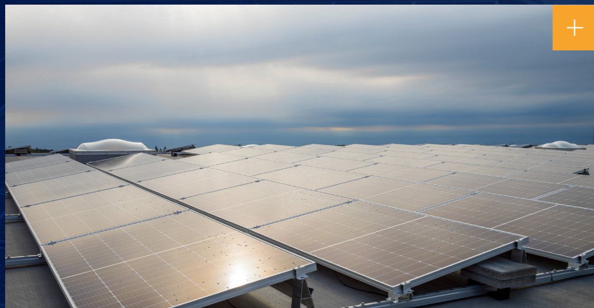
Électrification des processus et panneaux solaires photovoltaïques en toiture Division Insulation : Jönköping, Suède
