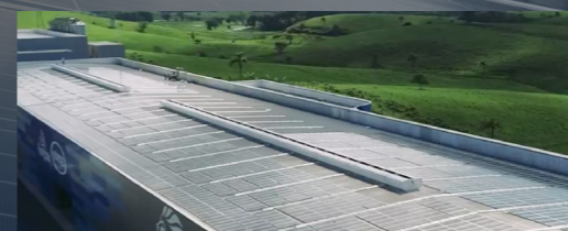
Panneaux solaires photovoltaïques en toiture Division Insulated Panels, Brésil : Araquari, Brésil Capacité : 1,9 MW
