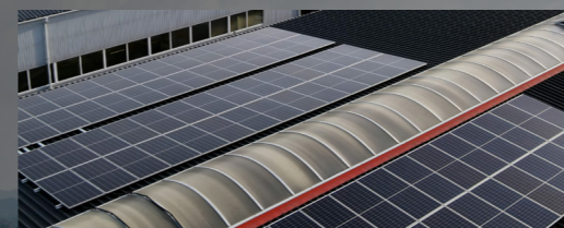
Panneaux solaires photovoltaïques en toiture Division Joris Ide : Bolszewo, Pologne Capacité : 0,9 MW
