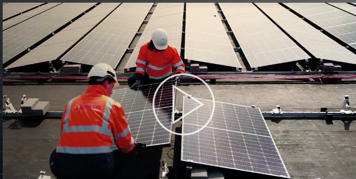
Panneaux solaires photovoltaïques en toiture Division Insulation : Gemert, Pays-Bas
