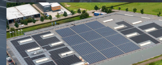
Extension de panneaux solaires photovoltaïques en toiture Division Insulation : Tiel, Pays-Bas Capacité : 0,9 MW
