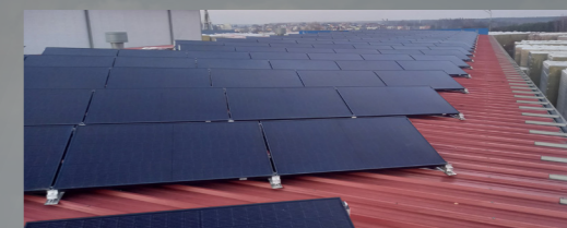
Panneaux solaires photovoltaïques en toiture Division Insulated Panels, CEER : Lipsko, Pologne Capacité : 0,05 MW
